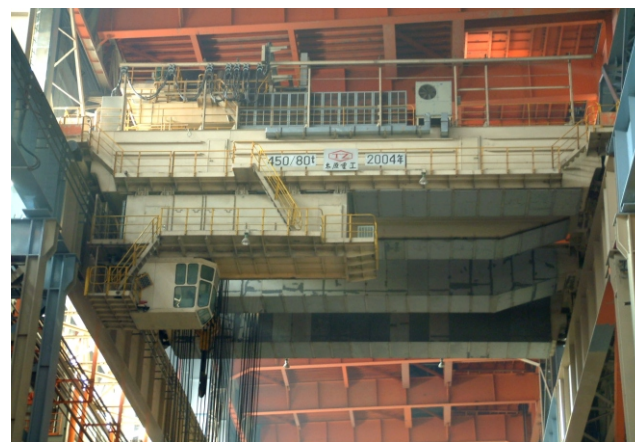
450t 铸造起重机 450t Ladle Crane
