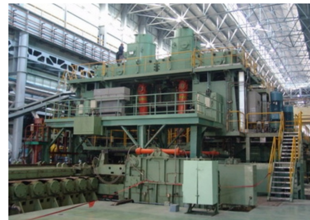
轧钢机驱动 Rolling Mill Drive
